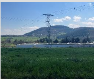
Pylône électrique sur l'OAP
