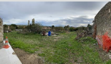
Mur en pierre à conserver et gravats et déchets
