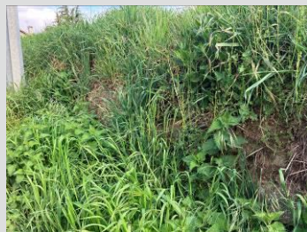
Muret en pierre envahi par la végétation
